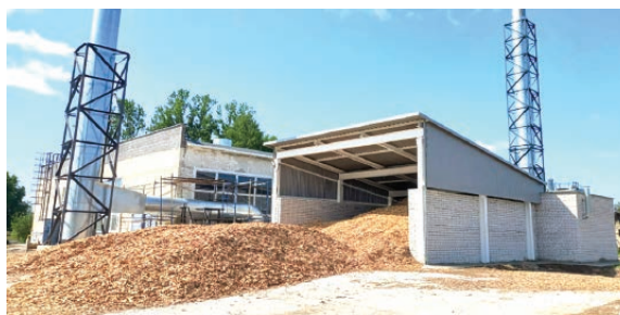
Котельная по ул. Тросницкой, ГП «ПКИТС» КУП «ЖКХ г. Полоцк»
