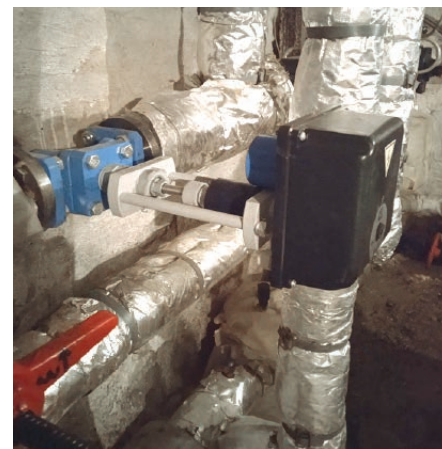
Типичное нарушение при эксплуатации систем регулирования – не подключен клапан
